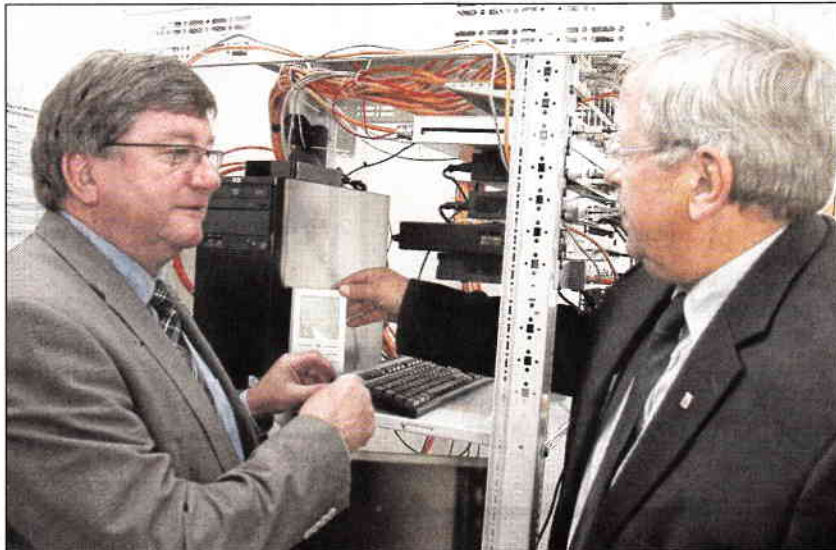
Viele Kabel, große Wirkung: Meinhards Bürgermeister Hans Giller zeigt Regierungspräsident Lübcke den Server, den zwölf Kommunen nutzen.
